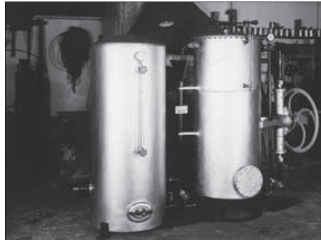
Aanvankelijk waren cv-ketels grote staande toestellen van gietijzer. (Bron: AWB)
